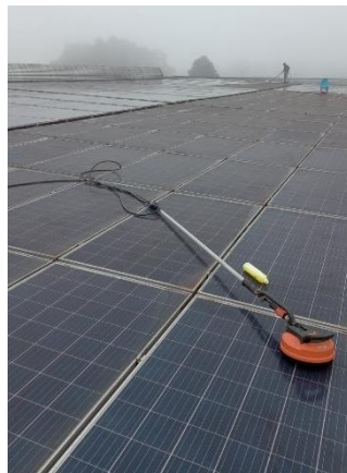
Figura 3 - Material para limpeza dos módulos fotovoltaicos. Imagem do Sistema FV 1.
