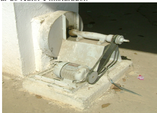
Figura 2: Vista do conjunto ventilador-motor.
